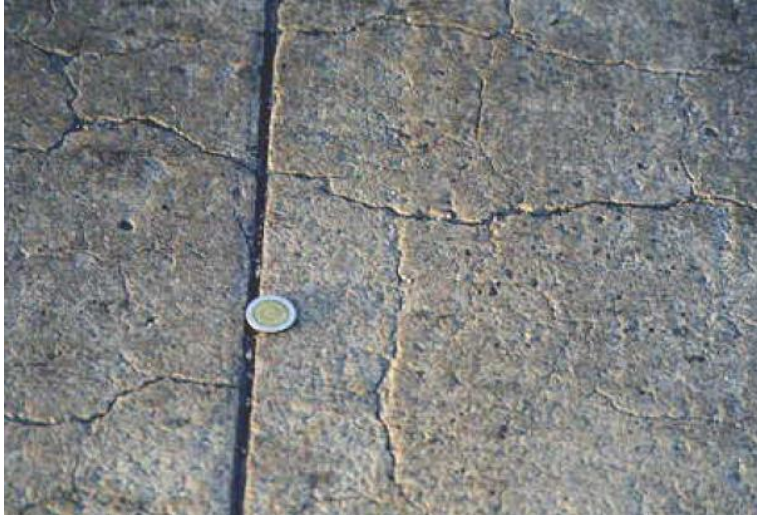
Fig. 13 – Fisura “pasante” la junta
