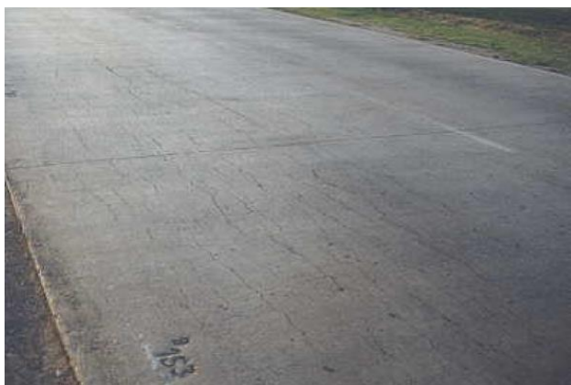
Fig. 12 – Fisuras orientadas al tránsito
