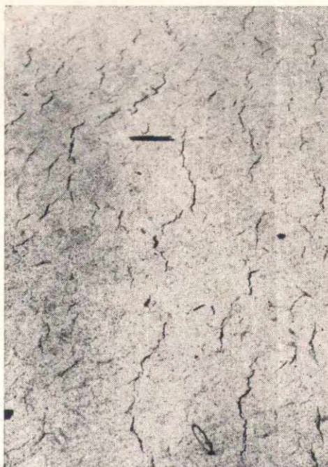
Figura 9. — Reacción álcalis-áridos. Agrietamiento de tipo estructural según líneas más o menos paralelas, producido por los esfuerzos derivados de las expansiones que provoca la reacción, sobre las losas del pavimento privadas de libertad de movimiento (Fava, Colina, Manuele y Cortelezzi, LEMIT).
