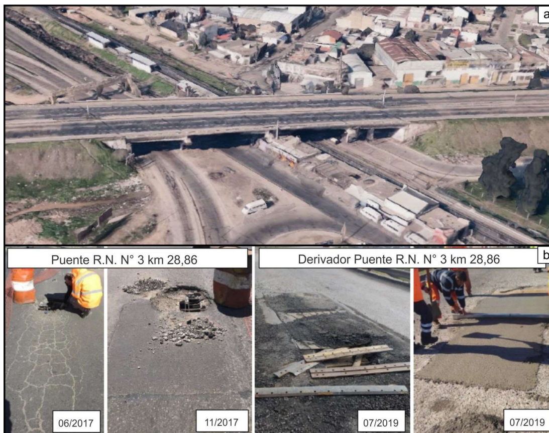
Figura 1: Puente sobre la RN N° 3. a) Vista panorámica del puente (imagen de Google Earth). b) Fallas en la losa de tablero en el puente principal y en un derivador.
